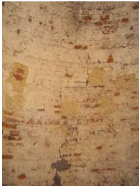
Torre Cilindrica. Fessura visibile sul paramento murario interno.
